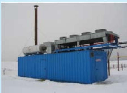
КТЭС 1мВт, шахта им. Кирова, Кузбасс
