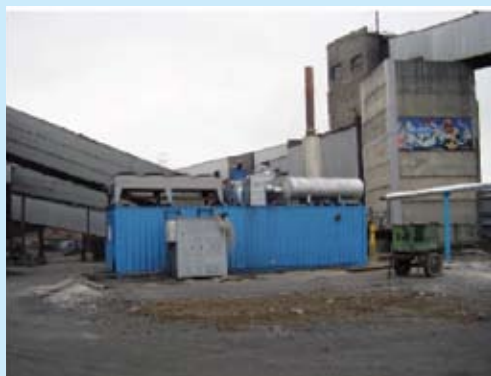
КТЭС 1,35 мВт, шахта 22 Коммунарская, Донбасс
