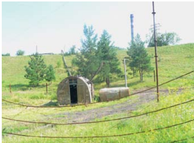
Передвижная дегазационная установка с водокольцевым насосом ВВН 50
